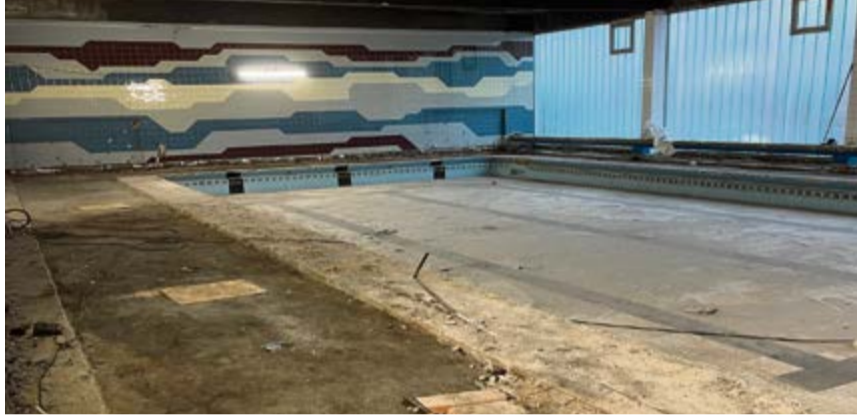
Die Rückbauarbeiten im Hallenbad haben begonnen. Weiter geht es mit der Geest-Turnhalle.
