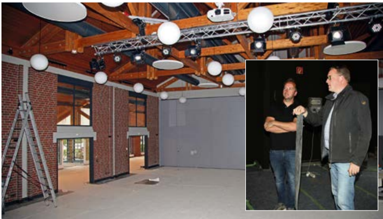
Tobias Nathaus (l.) und Markus Freck von der Stadt Olfen begutachten den Fortschritt beim Bau der Stadthalle.
