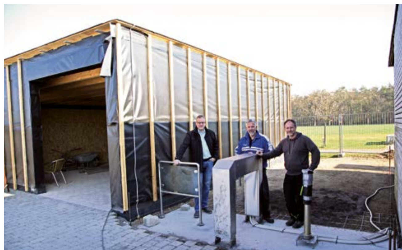
Die Bauarbeiten im Naturbad sollen zeitnah abgeschlossen sein: v.l. Markus Freck, Thomas Kunz und Markus Macek.
